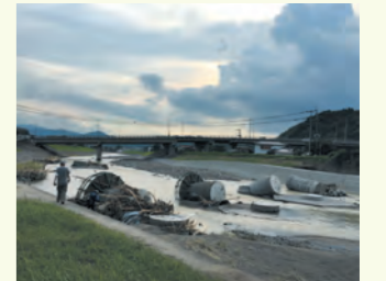
豪雨による増水で転倒した鉄道橋脚
